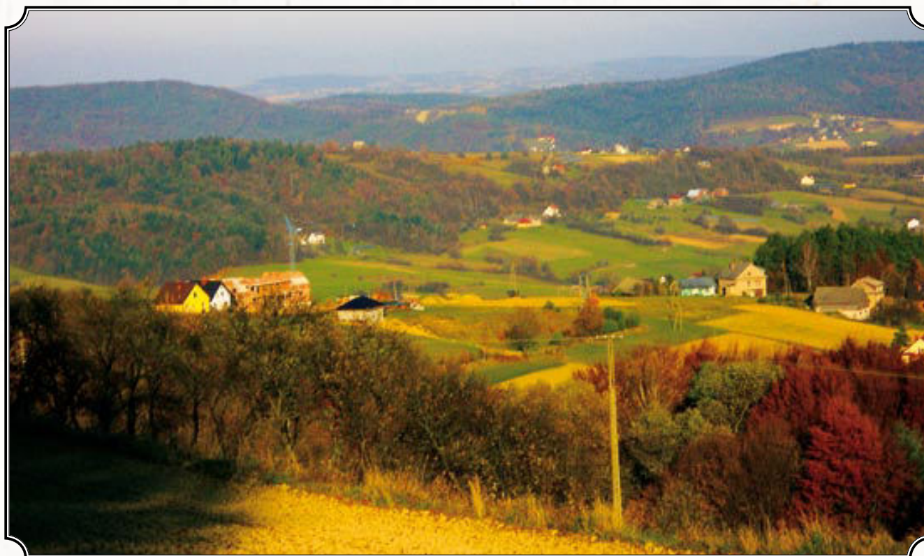
Widok z Wojakowej – Gór na okolicę. Na pierwszym planie budowa nyciagu narciarskiego – 2010 r., fot. B. Klimek; ze zbiorów GBP w Inkwowej.
