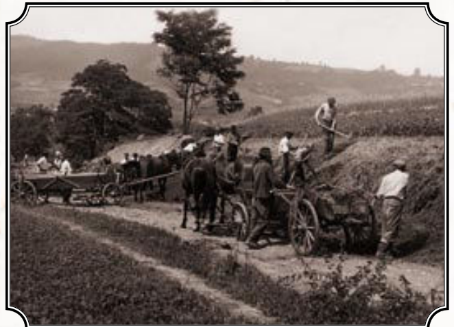
Dobrociesz – Wojakowa – budowa drogi w Kozinach. Sekretarz GRN w Porąbce Inkwoskiej – Stanisław Kryjowski sprawuje pieczę nad postępem prac, dróżnik Władysław Stanuch kieruje przebudową drogi, lata 1964-1965, fot. S. Klimek; ze zbiorów Cz. Klimek.
